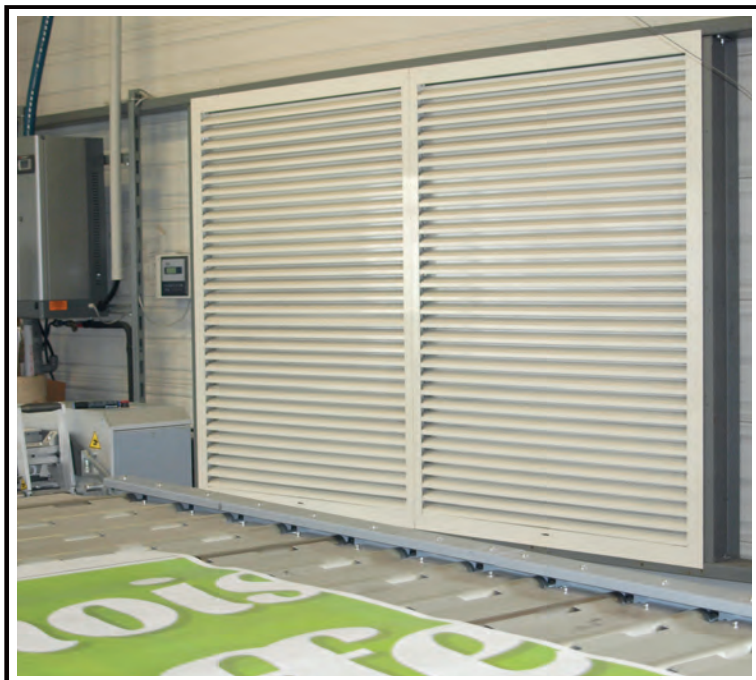
Grille de ventilation dans une imprimerie
