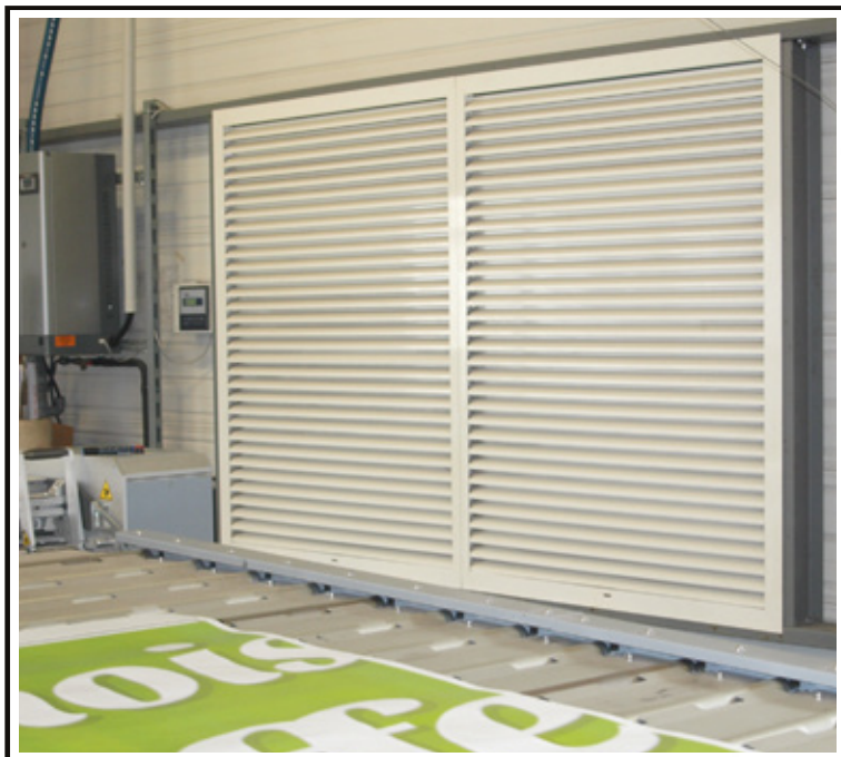
Grille de ventilation dans une imprimerie
